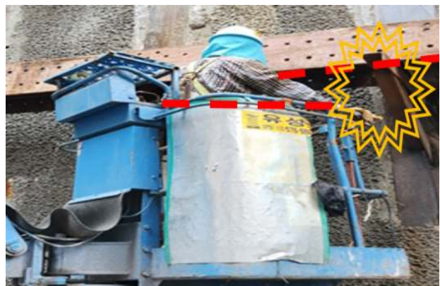
지하4층 하부 띠장 작업 구간에서 7단 띠장에 협착되어 오른손 검지 손가락 절단 ('23.07)
