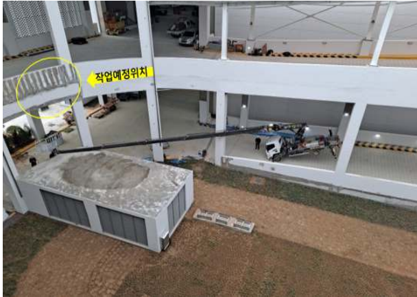
물류센터 차량탑재형 고소작업대 전도로 인한 근로자 추락 사망사고 ('22.12)
