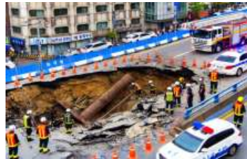
&lt;부산 사상구 싱크홀 사고&gt;
